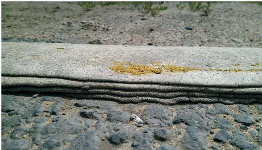
Рис. 5. Недопустимое (12 мм) возвышение горизонтальной дорожной разметки над поверхностью покрытия, на которое она нанесена
