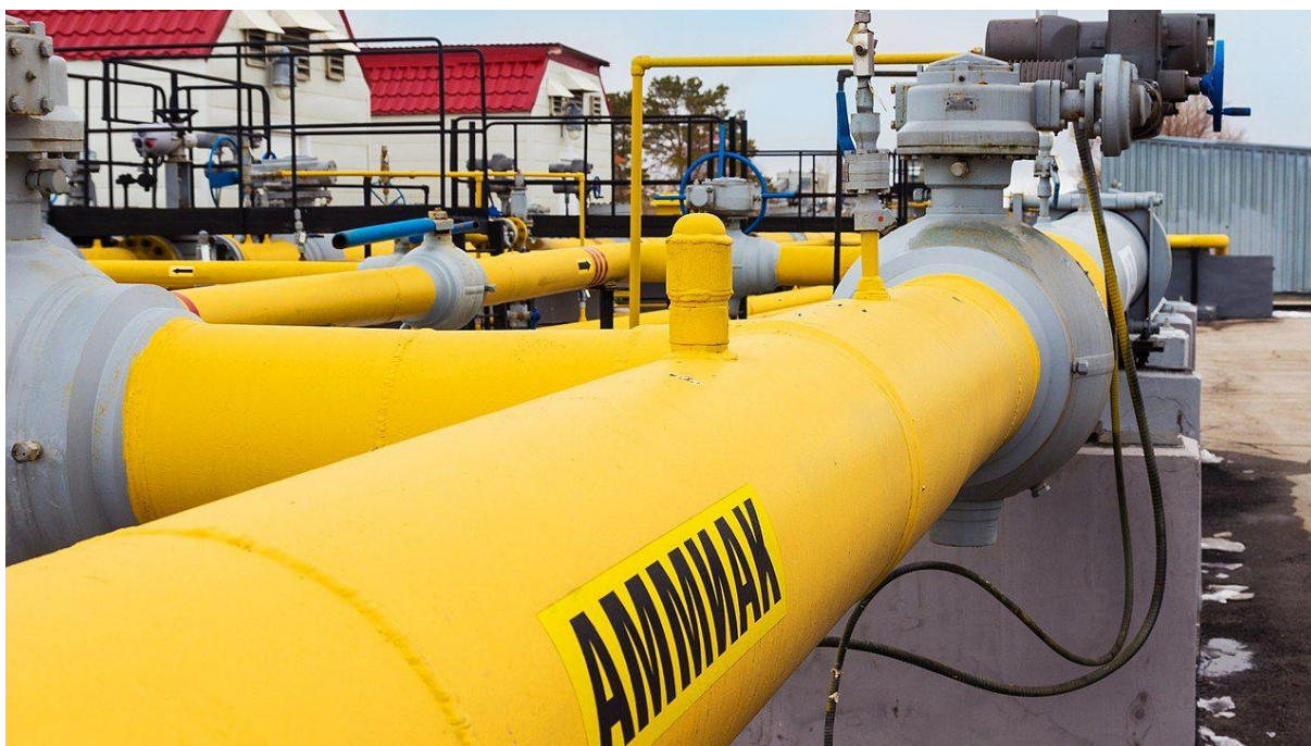
Рисунок 27 – Магистральный аммиакопровод «Тольятти – Одесса»
