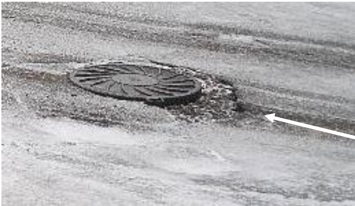
Рис. 22. Участок дороги с выступающим канализационным люком
