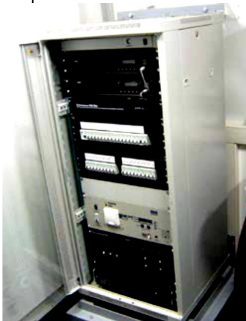
Рис. 1.17. Комплекс аппаратуры ретрансляции и телекоммуникации блочно-модульного исполнения (КАРТК)
