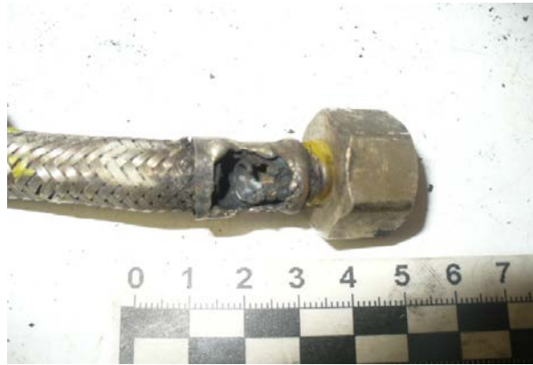
Рис. 1. Внешний вид повреждений гибкого газового шланга
