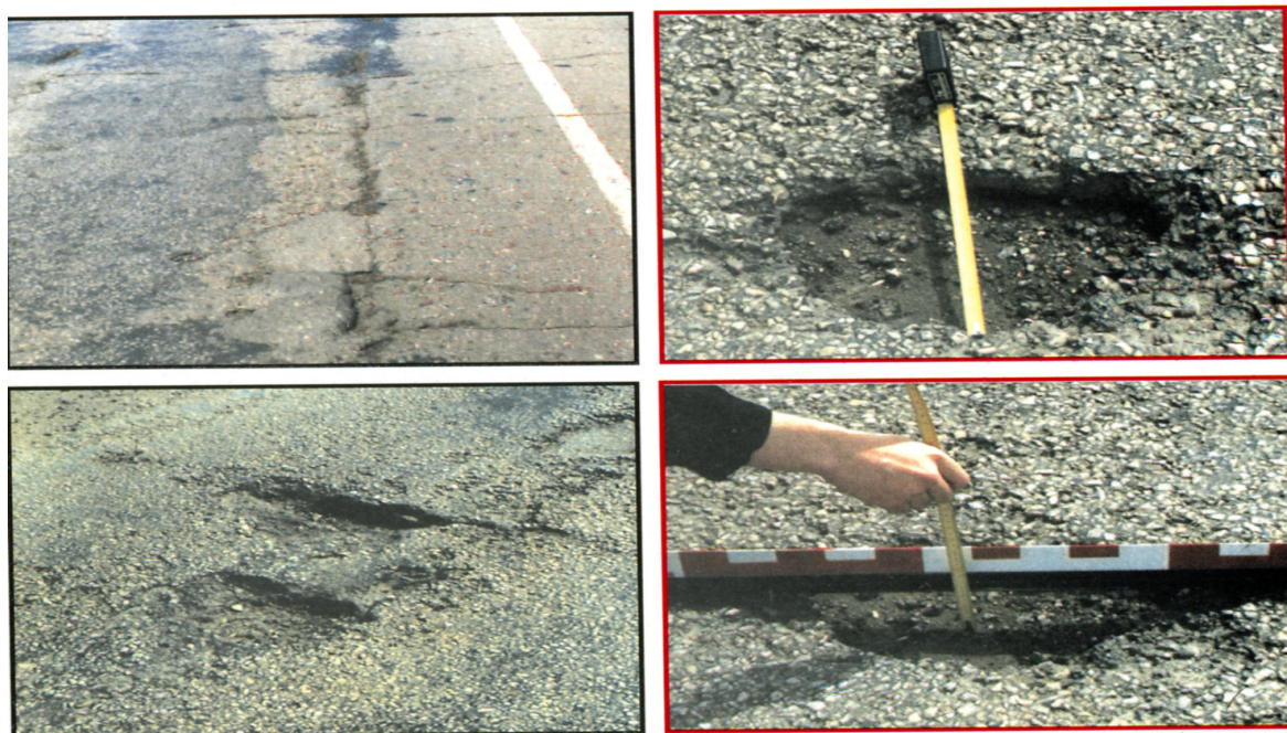
Рис. 1. Виды дефектов на проезжей части
