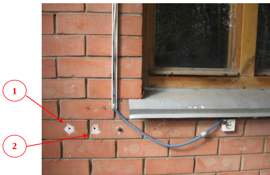
Иллюстрация № 8. Узловой снимок части восточной стены дачного дома №7 садоводческого общества «Мичуринец» с пулевыми повреждениями.
